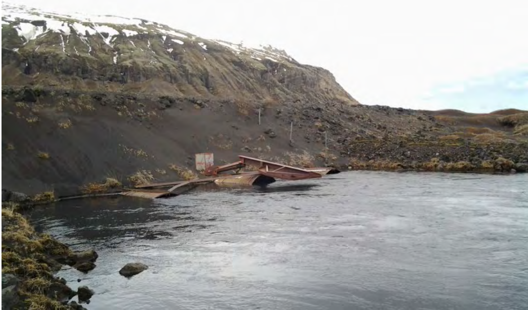
Mynd 18. Rör í stíflu við útfall Árkvísla 6. maí 2013. Svo djúpt er búið að grafa rörin að þau fara í kaf vegna bakvatns við 10 m 3 /s rennsli. Ljósmynd: Hilmar B. Hróðmarsson.
